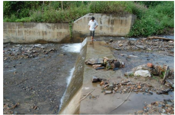
Hình 3. Bồi lắng đập dâng Nậm Tà La, Lai Châu
