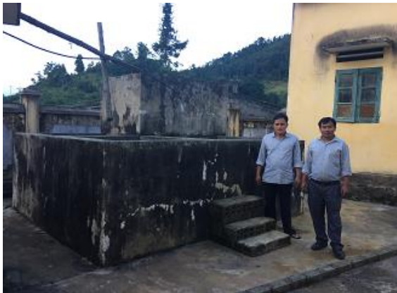
Hình 7. Bể chứa nước mưa cho trạm y tế xã Dìn Chín, huyện Mường Khương
