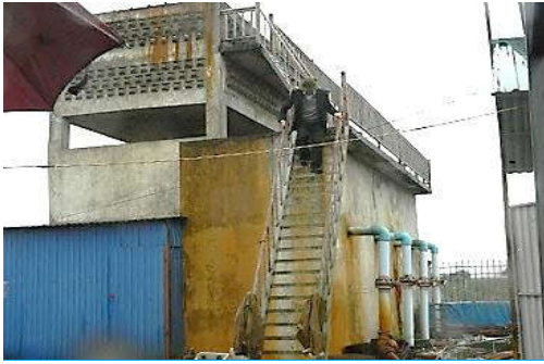
Hình 3: Trạm khai thác nước ngầm xã Thụy Hương
