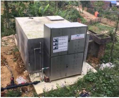
Hình 9. Tủ thiết bị lọc và bể chứa nước sạch
